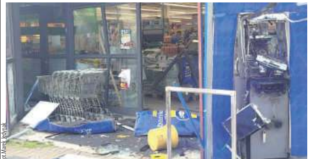
Skutki eksplozji podłożonego ładunku wybuchowego były tak silne, że zniszczeniu uległ bankomat i drzwi wejściowe do sklepu Stokrotka przy ulicy Tatarakowej w Lublinie
