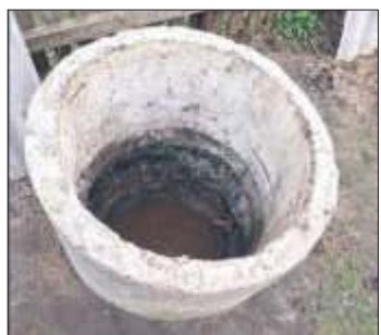
Ciało w zbiorniku na nieczystości odnalazł 71-latek, który zaniepokoił się faktem, że zasuwa szamba jest zdjęta. Fot. Policja
