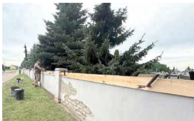
Fragmety ogrodzenia są bardzo zniszczone, inne pozostają w niezłym stanie. Roboty już trwają
