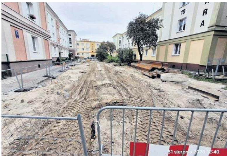
Na ul. Ikara/Orłowskiej termin zakończenia prac przesunięto na koniec października. Powód - niezainwentaryzowana sieć podziemna
