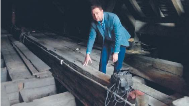
Miejska dotacja przyznana m.in. na renowację strychu kościoła to kropla w morzu remontowych potrzeb świątyni lubelskich ewangelików
