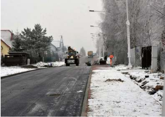
Wysafaltowany odcinek ul. Sosnowej
