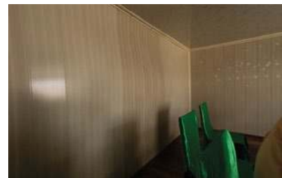
Ugięte ściany restauracji
