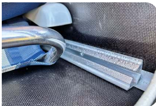
Wilgoć na metalowych elementach o poranku to zjawisko świadczące o sporej różnicy temperatur. Warto każdego ranka wycierać do sucha tego typu mostki cieplne
