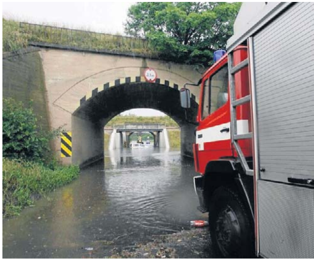
Podczas intensywnego deszczu ulica jest nieprzejezdna
