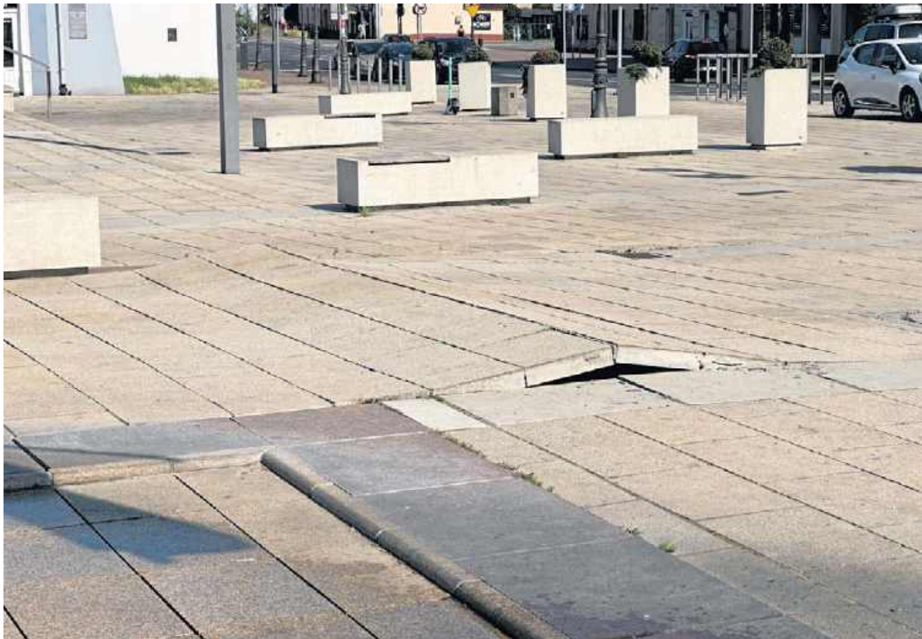
Ekstremalne upały zdeformowały płytę Starego Rynku w Częstochowie. Konieczna będzie naprawa nawierzchni
