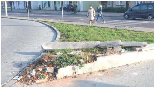
Zniszczony murek nie jest na terenie Biedronki, ale ze względu na estetykę firma rozważy jego naprawę
