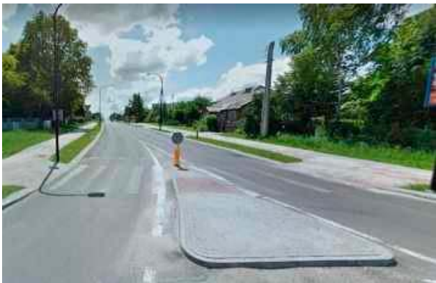
Przy ponad półtorakilometrowym odcinku Alei Lotników Polskich, jednej z głównych świdnickich ulic, wciąż nie ma kanalizacji i mieszkańcy są skazani na korzystanie z szamba
