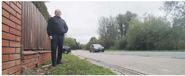
Bogdan Radwański przy zniszczonym ogrodzeniu swojej posesji przy Topolowej 49 w Chrzanowie. W tle zakręt śmierci
