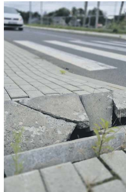
(e) Popękane płyty przy drodze serwisowej w Woli Filipowskiej
