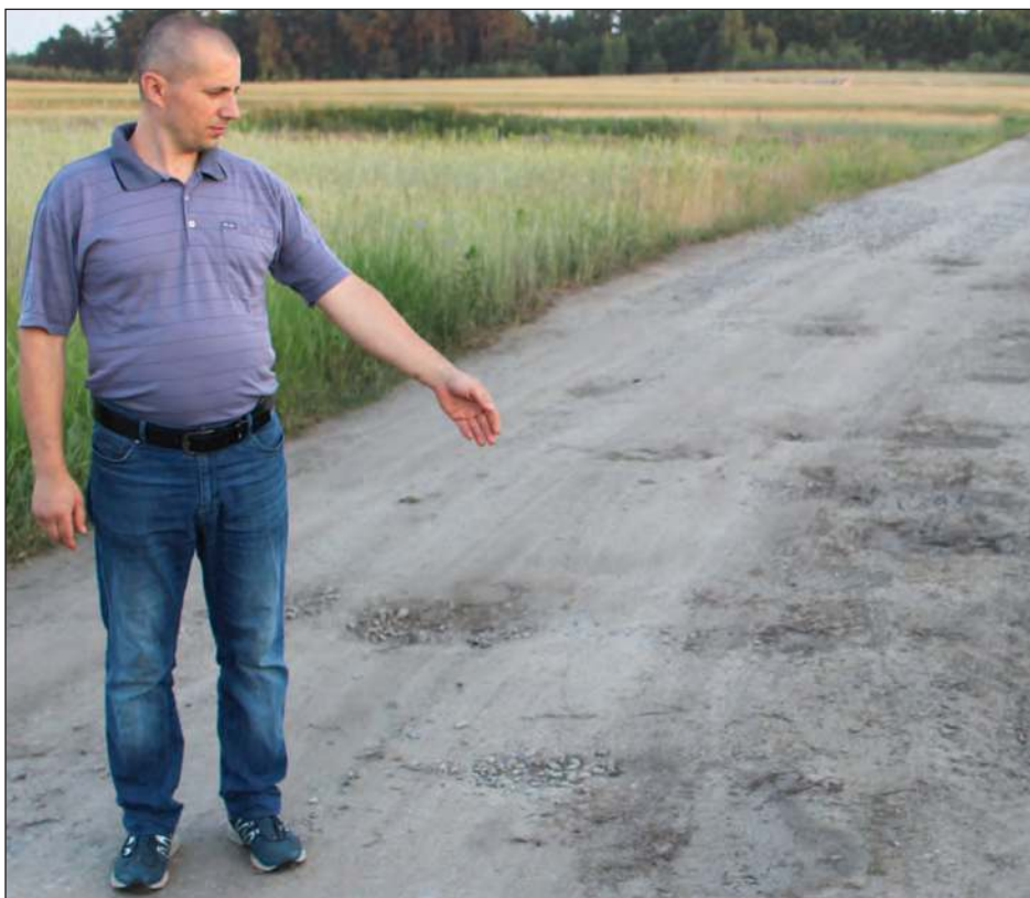
» - Droga jest w opłakanym stanie. Wójt obiecał, że w najbliższym czasie zostanie doraźnie naprawiona tłuczniem - mówi Adam Filipek
