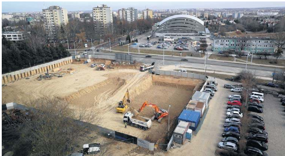
Plac budowy. U góry na dalekim planie widoczna jest hala Globus. Bloki mają być gotowe za nieco ponad dwa lata
