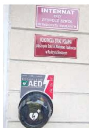
Defibrylator AED na budynku szkoły
