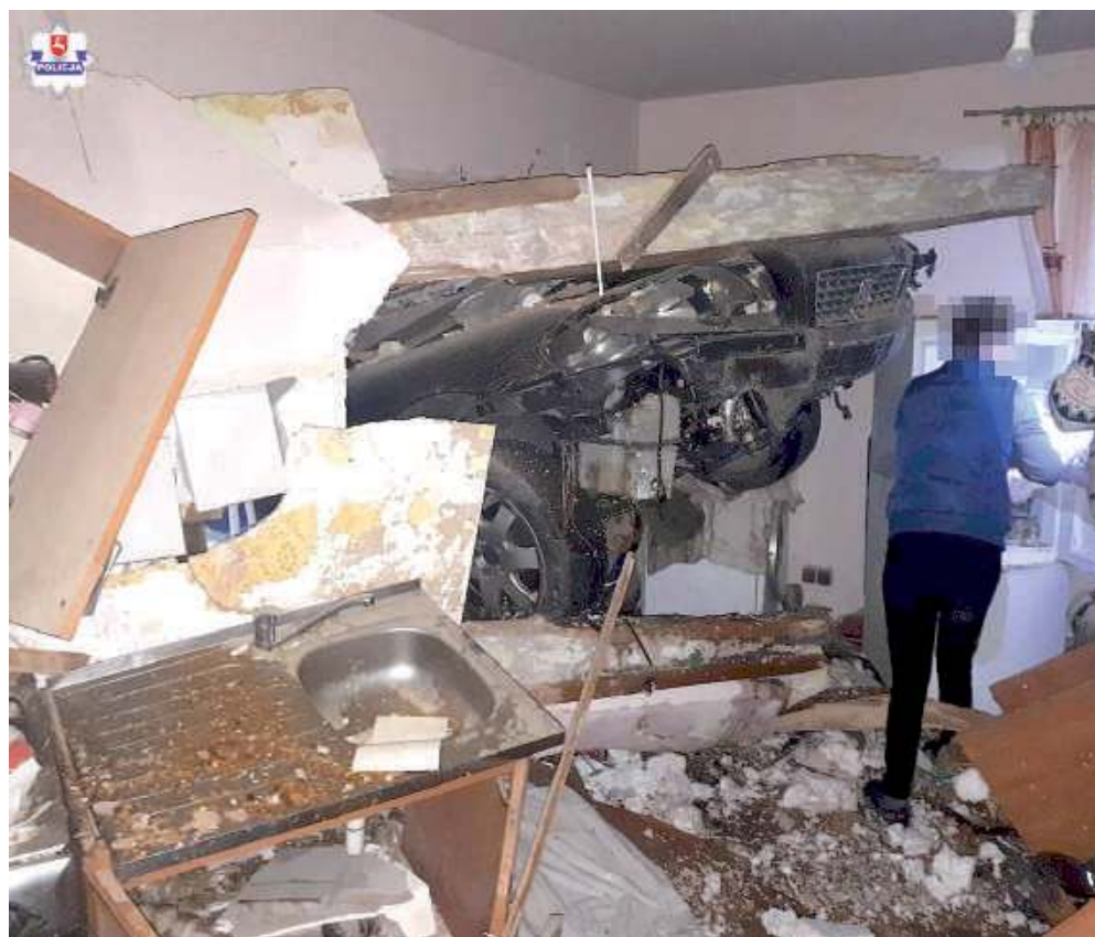
W tym czasie w budynku przebywał dziadek z dwojgiem wnucząt. Na szczęście nic im się nie stało
