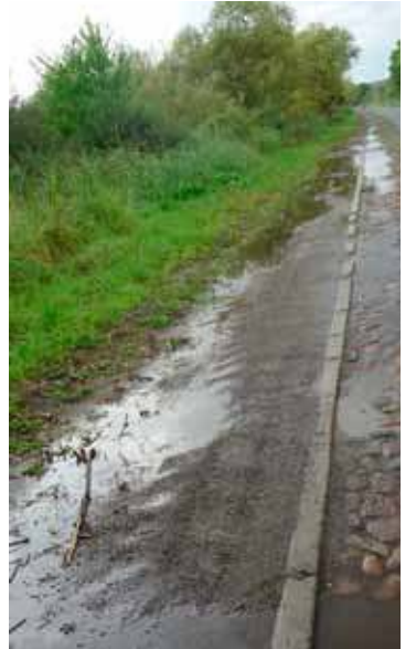
Na Międzyodrze zgodnie z zapowiedziami woda po deszczu zbiera się po jednej stronie drogi.
