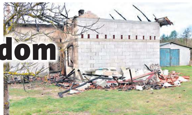
Szczyt musiał zostać przewrócony, istniało zagrożenie zawalenia się ściany. Fot. (kt)
