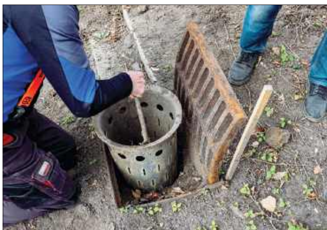
■ W studzienkach ściekowych zachowały się jeszcze wyjmowane odstojniki
