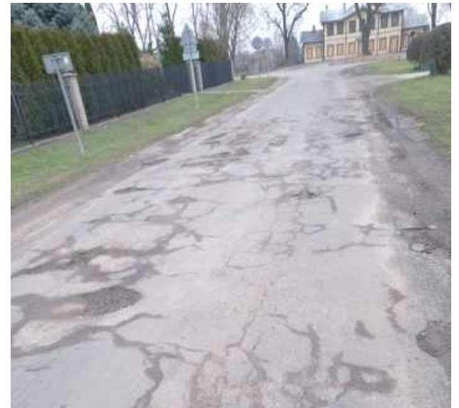
Droga w Sadurkach od dawna aż prosiła się o remont
