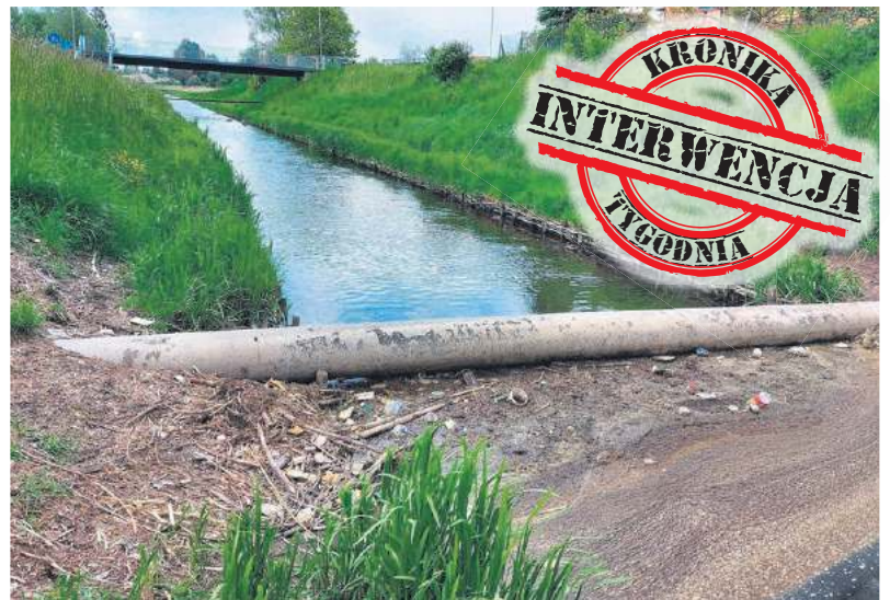
A tak było przed wielkimi porządkami.
