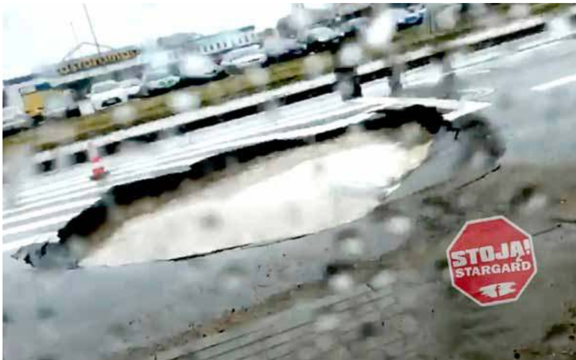
Na Kościuszki, jak pamiętamy 1 lipca po ulewach, powstała ogromna wyrwa w jezdni. Foto. Stojq!Stargard
