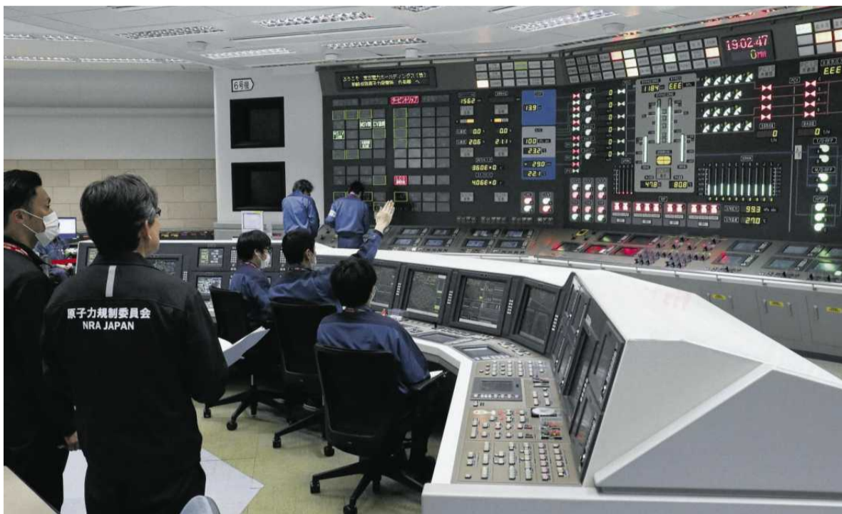
• Japońska elektrownia jądrowa Kashiwazaki-Kariwa FOT. KYODO/VIA REUTERS
