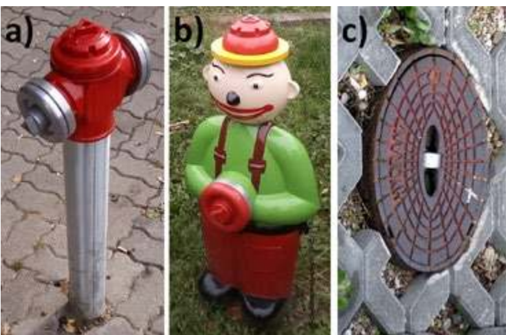
Fot. 5. Hydranty nadziemne (a, b) oraz podziemne (c) umożliwiające czerpanie wody do celów przeciwpożarowych.
