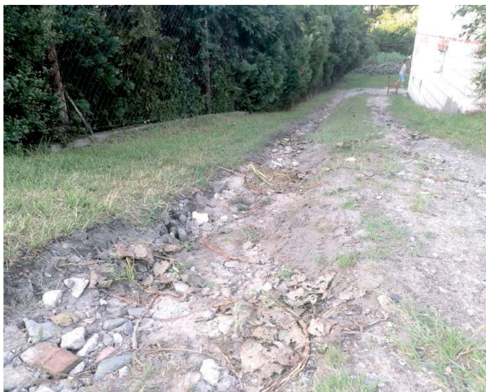
Po ostatnich opadach wyjazd z posesji stał się bardzo utrudniony. Rwący strumień wody płynący z ulicy wymył ziemię z drogi wjazdowej. Żeby przejechać kilkumetrowy odcinek samochodem, trzeba się nieźle nagimnastykować
