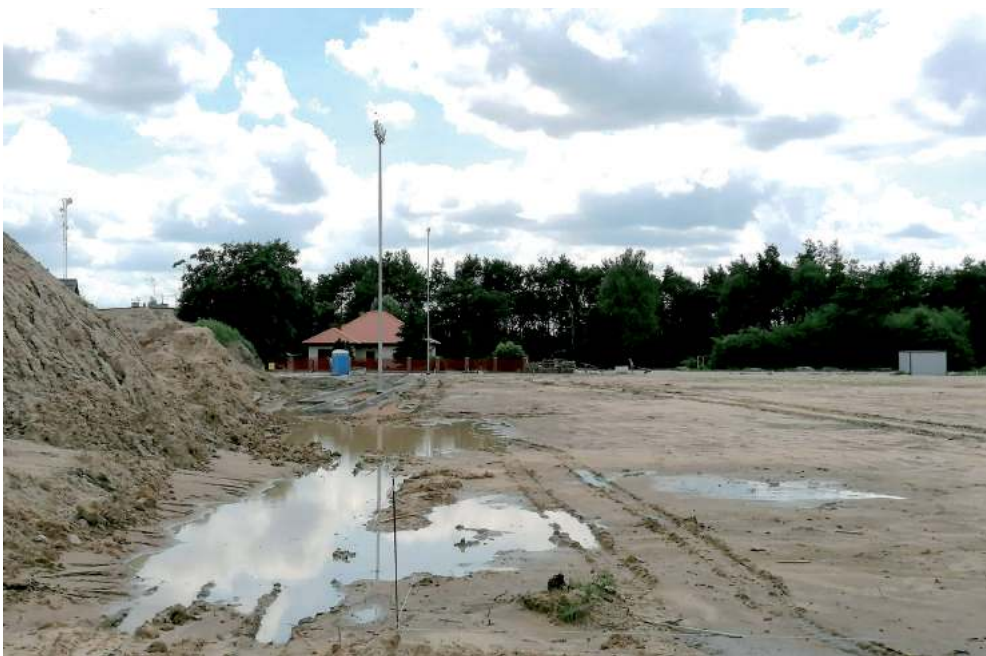
To zdjęcie zrobiliśmy w piątek. Po opadach deszczu na placu budowy boiska tworzą się zastoiska wody. Zdaniem wójta woda ma prawo stać, bo prace jeszcze nie są zakończone
