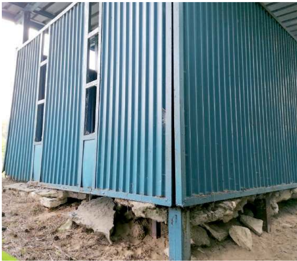
Przystanek został odmalowany. Ale wójt nie wywiązał się z obietnicy i nie utwardził terenu, na którym stoi metalowa wiatka. Betonowa posadzka popękała i odpada po kawałku
