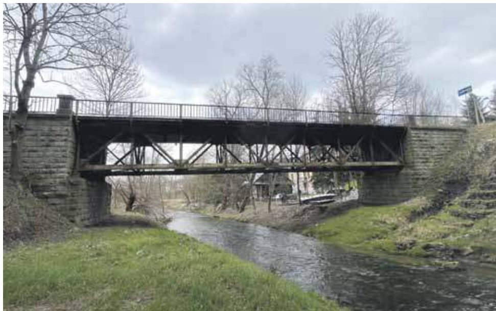
Most na Rabie grozi zawaleniem.
