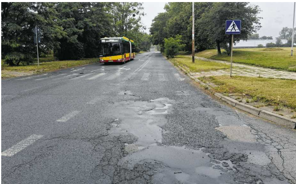
• Ulica Śnieżna wymaga pilnego remontu
