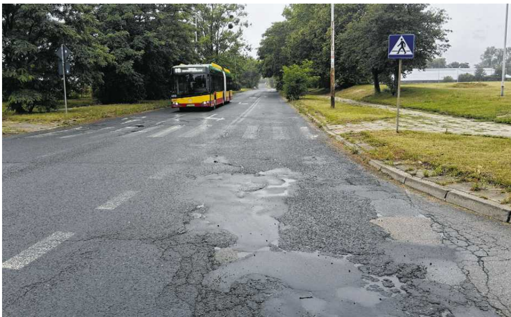
• Ulica Śnieżna wymaga pilnego remontu
