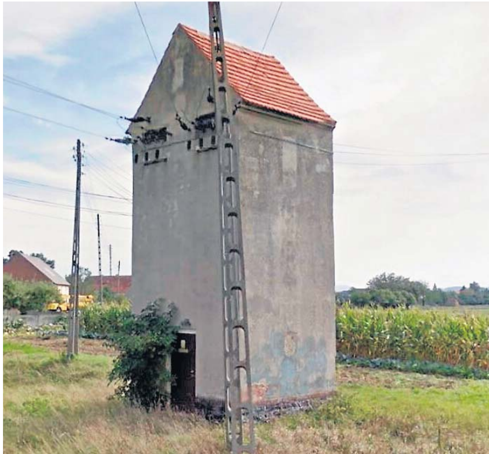
Transformator w Olszanach, w którym dokonano niespodziewanego odkrycia
