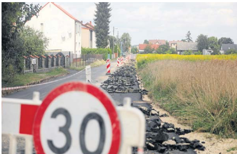
Droga przeorana przez ciągnik ma zostać naprawiona
