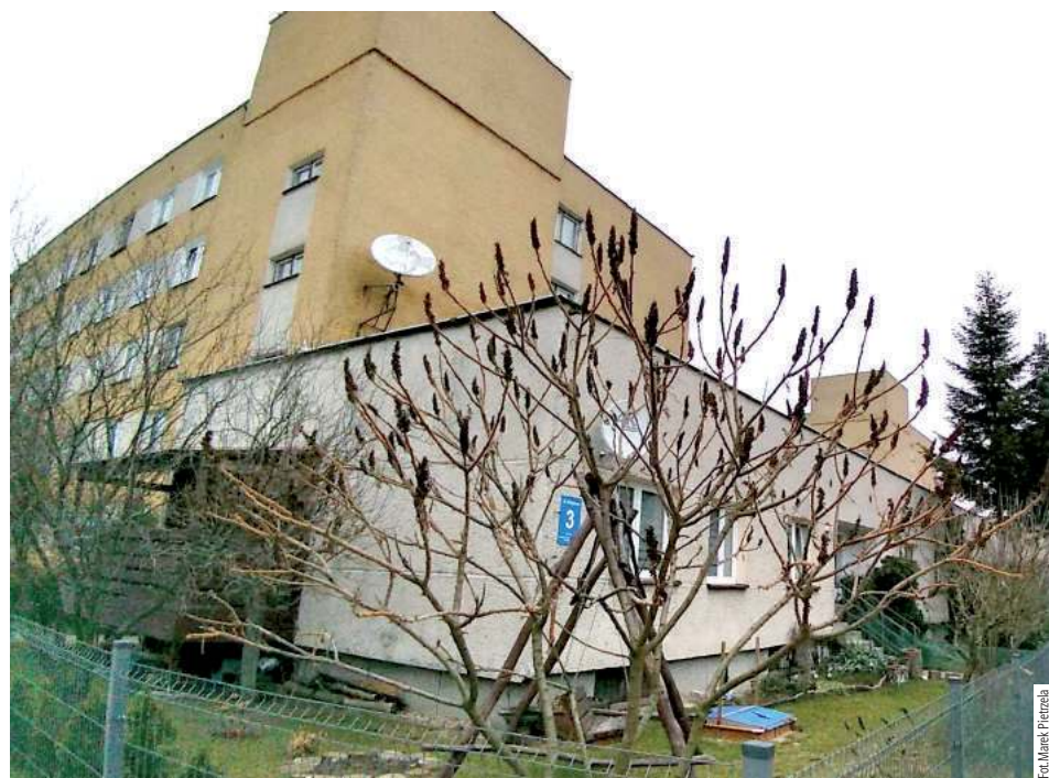
Duża część okien w budynku tzw. hotelowym przy ul. Okopowej 3 wymaga wymiany stolarki
