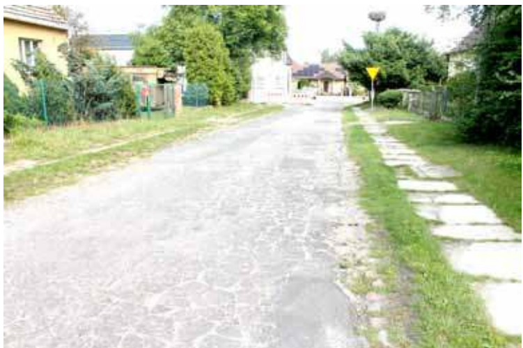
Droga na ul. Kossaka, jak mówią jej mieszkańcy, potrzebuje natychmiastowego remontu
