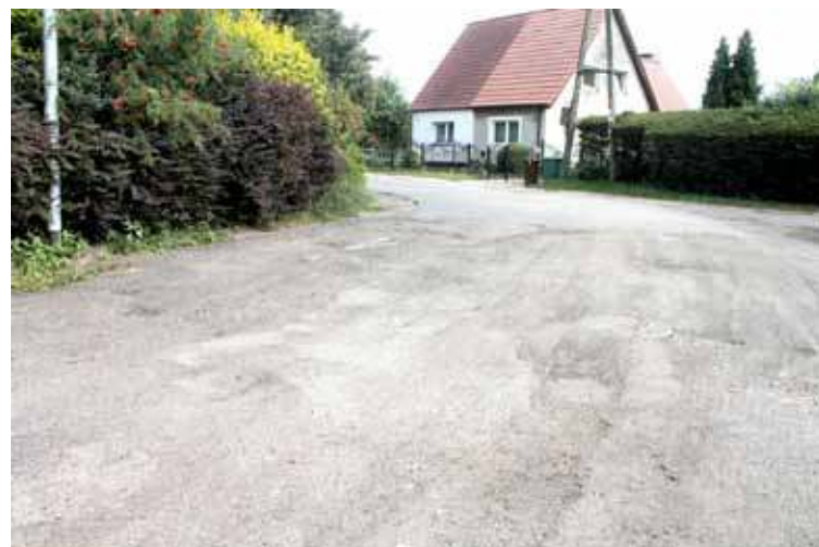
W tym miejscu kończy się asfalt. W ubitym fragmencie drogi powstały spore dziury.
