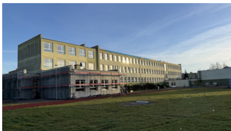
Jednym z najrozsleglejszych projektów była poprawa efektywności energetycznej Szkoły Podstawowej nr 5 oraz Szkoły Podstawowej nr 6. Prace o łącznej wartości 11 056 224,07 zł objęły wymianę stolarki okiennej, docieplenie ścian oraz modernizację oświetlenia i instalacji c.o. Na realizację tego zadania gmina pozyskała dofinansowanie zewnętrzne w wysokości 9 014 717,12 zł.
