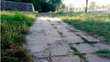
Część połamanych chodników na zamkowych błoniach wciąż czeka na remont
