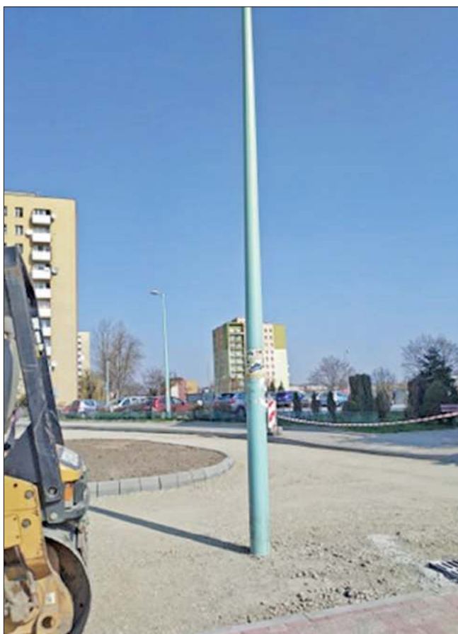
Przez błąd w projekcie na środku remontowanej drogi na Placu Zwycięstwa w Wodzisławiu Śl. stanęła latarnia. Już niedługo drogowy absurd ma zostać zlikwidowany.
