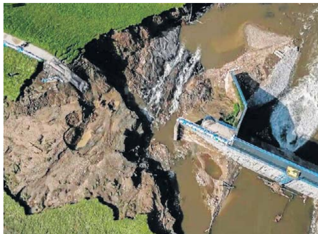
Przerwane umocnienia w Stroniu Śląskim. Zdjęcie zrobiliśmy we wrześniu 2024 roku
