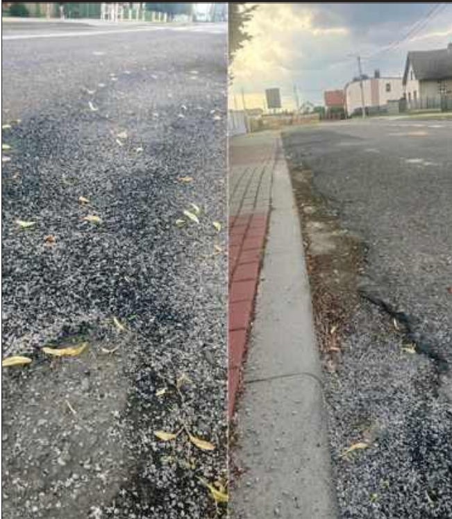
■ Remont drogi na ul. Raciborskiej w Bojanowie nie przyniósł oczekiwanych efektów
