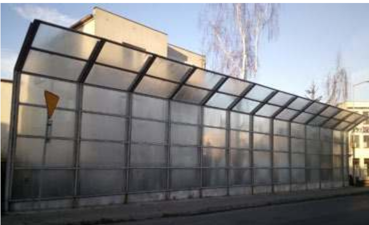
Fot. 3. Ekran akustyczny chronią przed hałasem komunikacyjnym.
