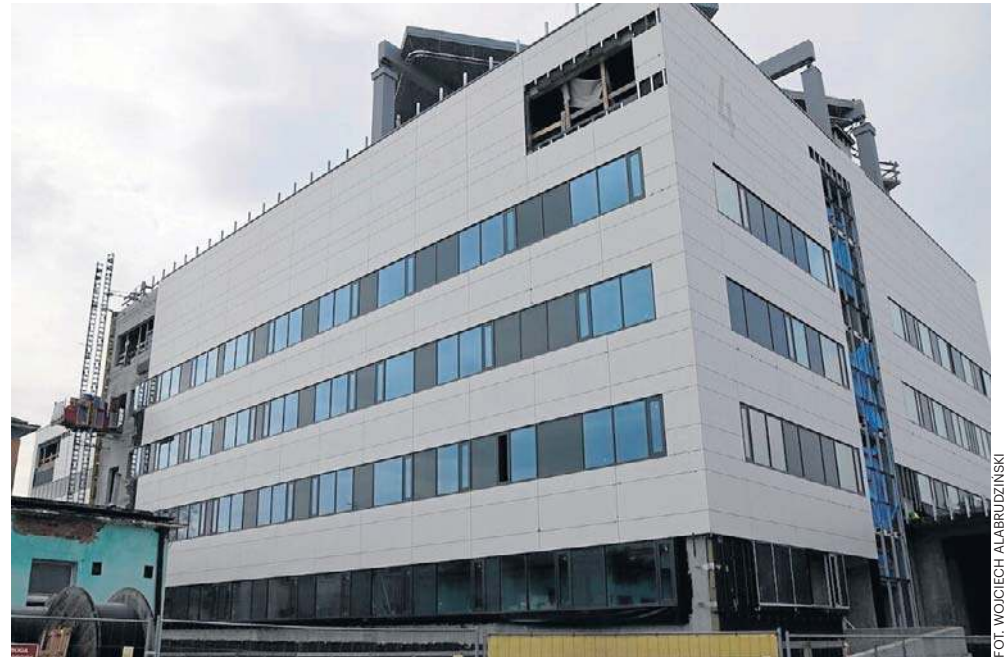
Trwa budowa nowego gmachu szpitala. Ma być gotowy za rok, natomiast w 2028 przy lecznicy ma być wielopoziomowy parking
