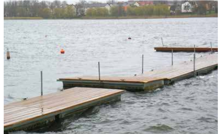
Pomost, który nie ma nawet roku, już czeka na naprawę
