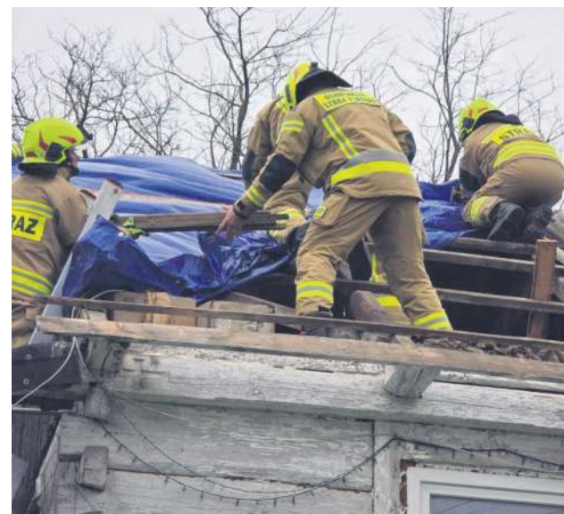
Skutki przejścia frontu atmosferycznego i związanych z nim silnych oraz gwałtownych porywów wiatru były widoczne w całym powiecie hrubieszowskim.
