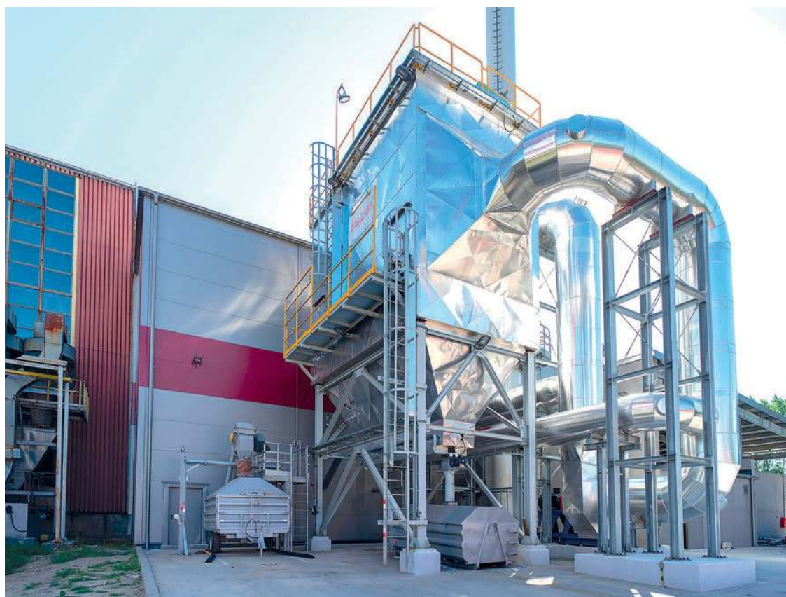
Teren Elektrociepłowni (ul. Tysiąclecia). Kogeneracja wykorzystująca biomasę (zrębki).
