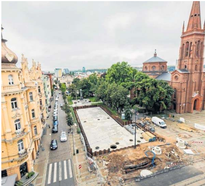
Jeden z większych zbiorników retencyjnych w Bydgoszczy powstał w 2023 roku na Placu Wolności
