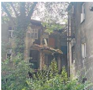
Runęła część kamienicy, która była niezamieszkała
