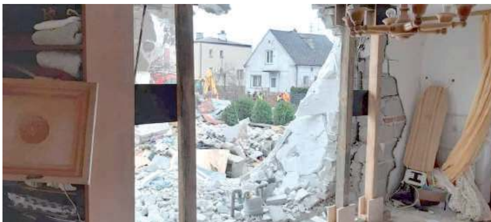
W jednym z sąsiednich domów wybuch uszkodził ścianę nośną. Nadzór budowlany wyłączył budynek z użytkowania
