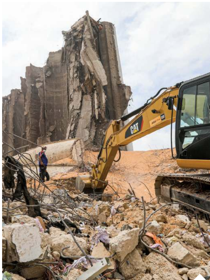
Wybuch zniszczył jedyny elewator zbożowy, to zaś powoduje problem z dostępem do żywności | fot. MOHAMED AZAKIR/Reuters/Forum
