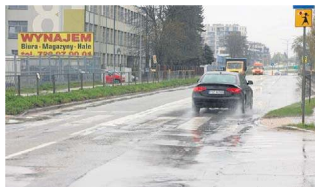
Ulica Wrzosowa od dawna jest jedną z bardziej zużytych ulic w tej części Kielca, a kierowcy zwracają uwagę przede wszystkim na wyeksploatowaną nawierzchnię i pogarszający się komfort jazdy
