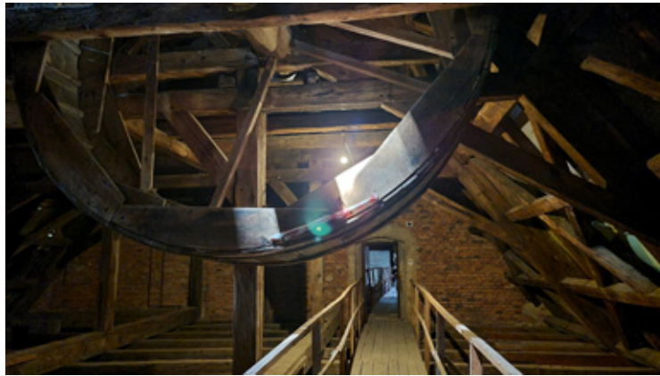
Na strychu zachował się oryginalny ślad codzienności cystersów - koło, którym zakonnicy wciągali na strych materiały.
