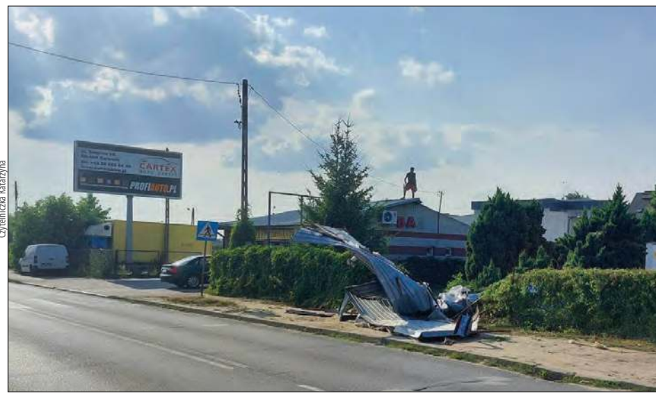
Podmuch zerwał dach z budynku, w którym mieści się sklep Czarny Antek przy ul. Targowej
