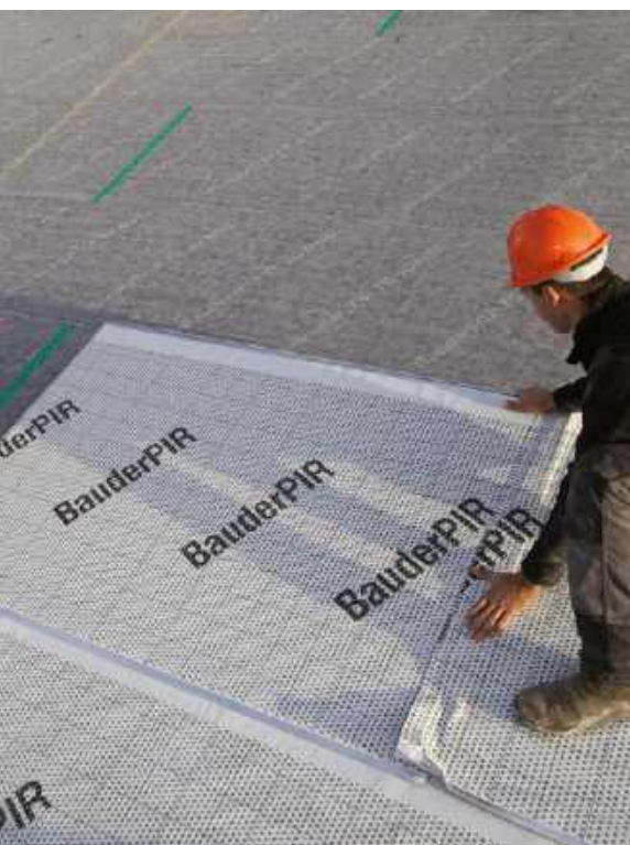
🔴 Kunie trudno jest pokonać barierę, jaką jest ocieplenie nakrokwiowe wykonane z twardych płyt izolacyjnych. BAUDER
