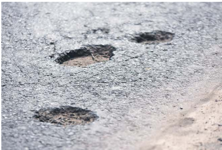
Dwa lata po remoncie drogi, a tu takie „kwiatki”.
